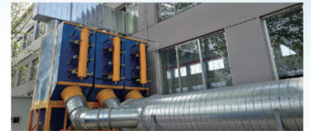
山西金能移动能源有限公司 (过滤式除尘器) Shanxi Jinneng Mobile energy Co.,Ltd (Filter type precipitator)
