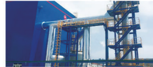
中国石油大连分公司 (污水污泥处理) Dalian Branch of CNPC (Sewage and sludge treatment)
